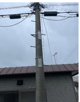
⑪北電柱（NTT共架） 32-42-09-55-39-49 （第北幹4右5）
